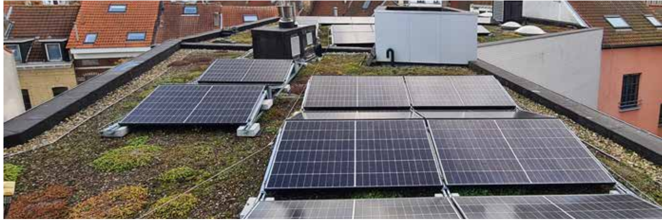
Panneaux photovoltaïques et toiture verte - Maison de quartier Malibrant, 10 rue de la Digue
